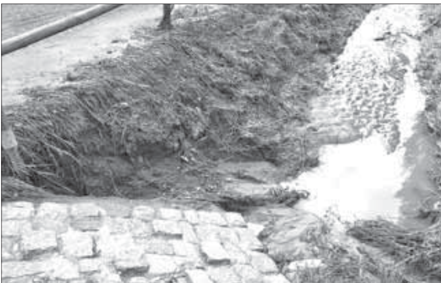
Seefeld-Löhme. Graben im Siedlerweg. Böschungsabrutschung an der Böschung und Einspülung von Ackersand.
