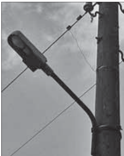
Typische alte Mastansatzleuchte mit Quecksilberdampfleuchtmittel
