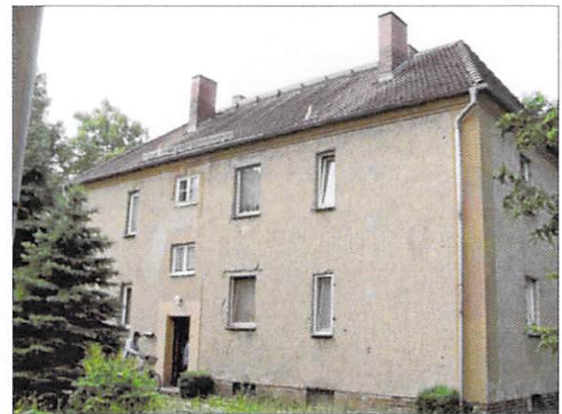
Wesendahler Straße 16: An der Eingangsseite wurde anstelle der ehemals schmalen Fenster ein breiteres Format eingebaut. Die neuen Fenster springen aus der horizontalen Fensterachse.
